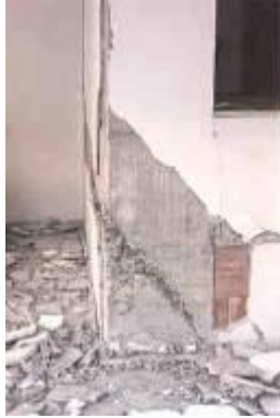
Resim-2: Orta hasarlı bina
