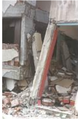
Resim-4: Hasarlı kolon
