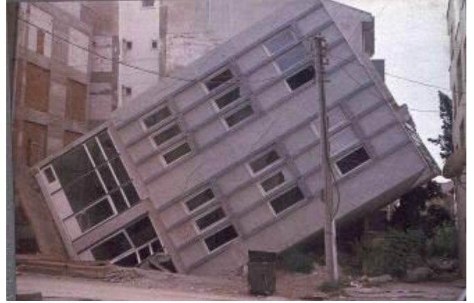
Resim-5: Stabilitesini kaybetmiş, ağır hasarlı yapının dış görünümü.
