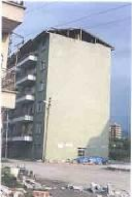
Resim-1: Az hasarlı bina
