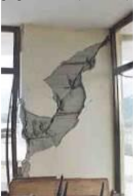
Resim-3: Hasarlı perde
