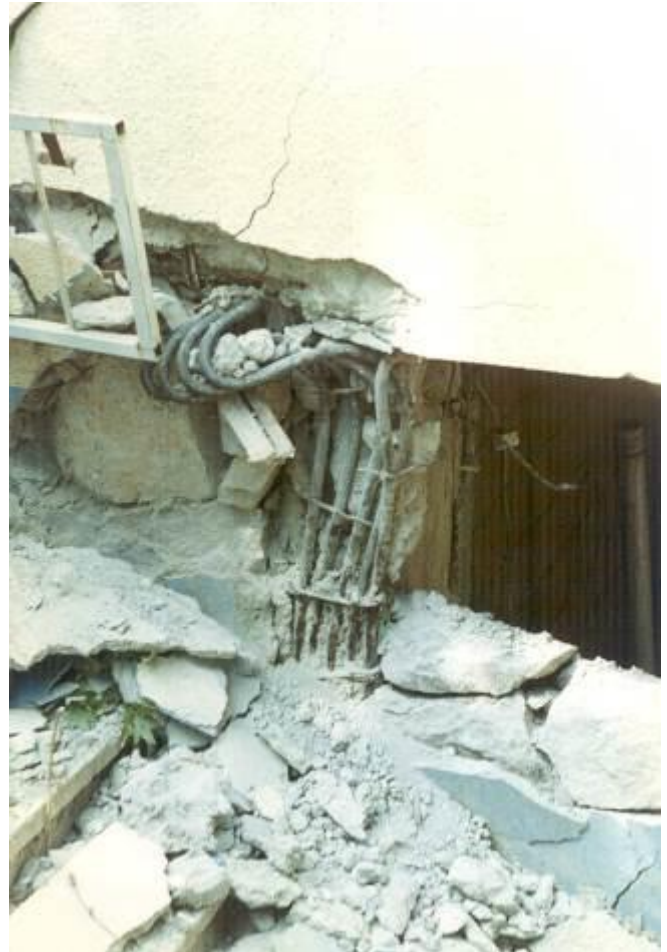
Resim-2: Dinar Lisesi'nde bodrum katta kısa kolon davranışı nedeniyle kolonda oluşan hasar.
