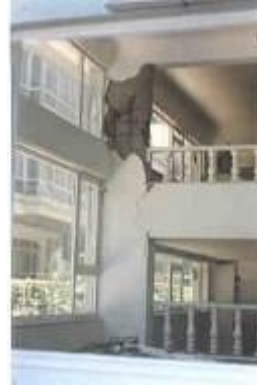
Resim-9-10: Kısa kolon oluşumları
