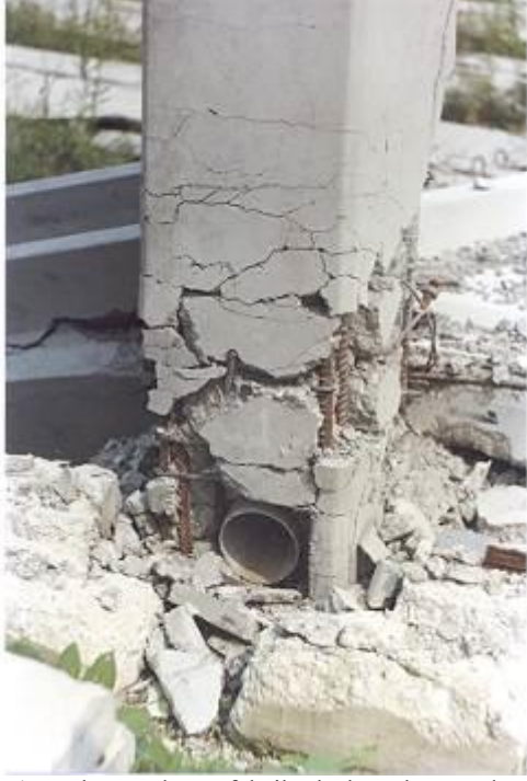
Resim-15: Akyazı'da prefabrike kolon alt ucundan geçen PVC boru görünümü.
