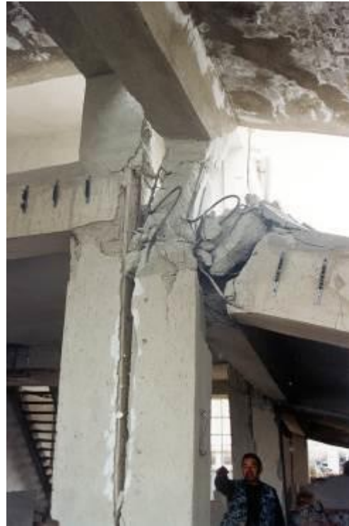
Resim-19: Sanayi sitesinde kısa kolon hasarlı betonarme bina iç görünümü.
