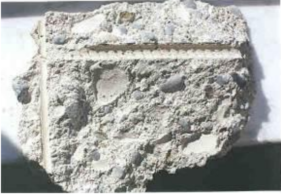
Resim-16: Kalitesiz beton görünümü.
