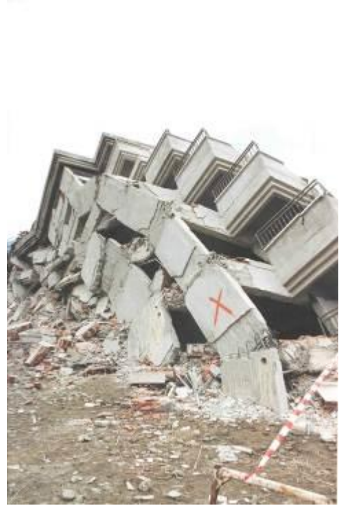
Resim-18: Çay ilçesinde göçmüş, betonarme perdeli bina.
