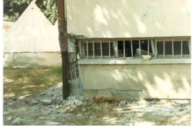
Resim-1: Dinar Lisesi'nde bodrum katta kısa kolon davranışına neden olan bant pencereler.
