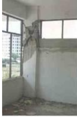
Resim-11: Kısa kolon hasarı
